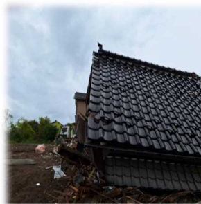
未だに放置されたままの倒壊家屋
