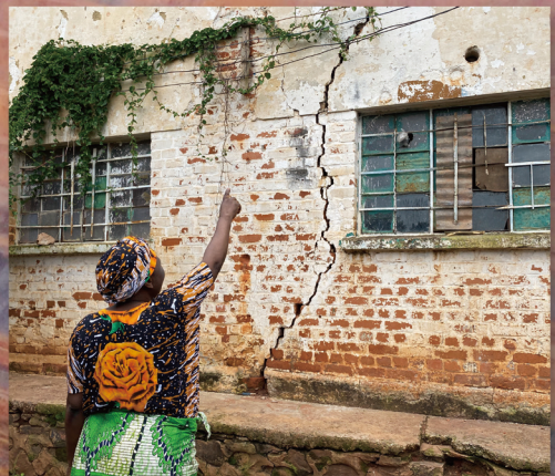
発破採掘の影響で家の壁に割れ目が生じている。
